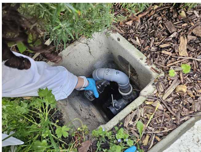
Figure 14 : prélèvement au niveau du pilote 2, contenant uniquement des plantes phyto épuratrices (absence de vers)
